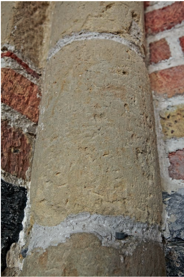
FIG. 28 Noordkoor, schalk in de eerste westelijke travee. Blokken beigebruine Ledesteen met opvallende schelpgeesten en bruine oxidatievlekken (verweerd pyriet en/of glauconiet). Northern choir, shaft in the first western bay. Blocks of beige-brown Lede stone, containing conspicuous fossil moulds and brown oxidation spots (weathered pyrite and/or glauconite).
