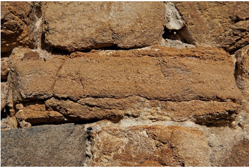
FIG. 6A Steen van Marquise in de zuidwand van de westtoren. Oranjebruin verkleurde, grofkorrelige oölitisch-bioklastische kalksteen bestaande uit kalkbolletjes (oöiden) en gerold fossielgruis (bioklasten).
